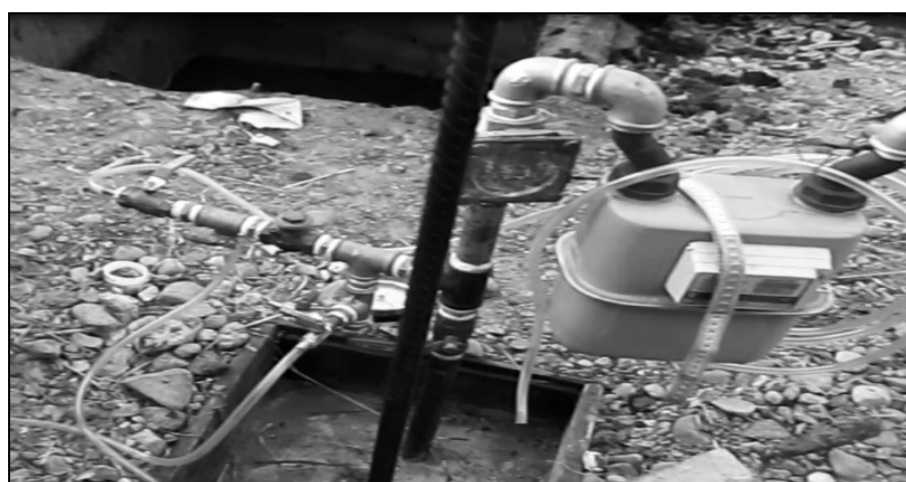
شکل ۱۱- تجهیزات اندازه گیری دبی
