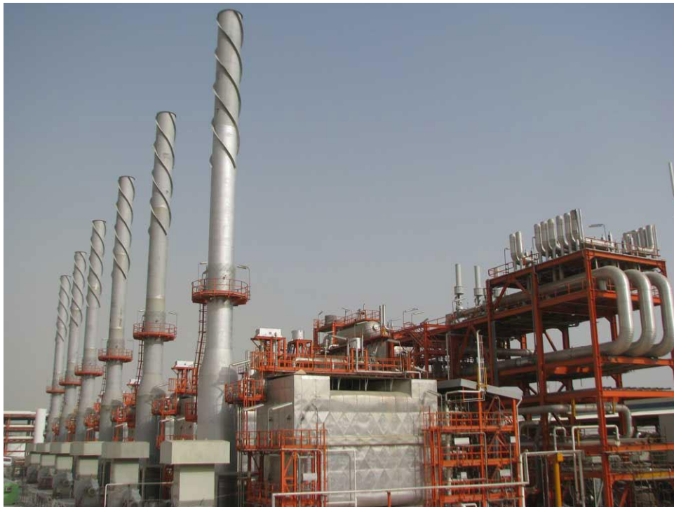
شکل ۱- بویلرهای پالایشگاه چهارم مجتمع گاز پارس جنوبی
