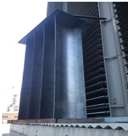
شکل ۳- پره راهنمای نصب شده در نیروگاه منتظر قائم
