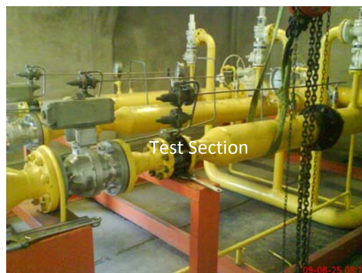
شکل ۲- بستر آزمون: خط ۱ ایستگاه تقلیل فشار گاز
