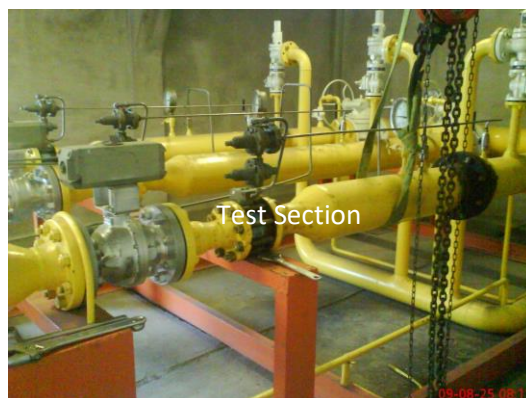
شکل ۲- بستر آزمون: خط ۱ ایستگاه تقلیل فشار گاز
